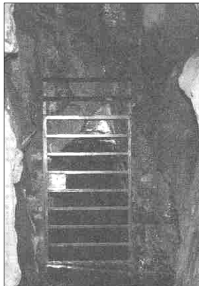
Photo 2 : Grille de protection
